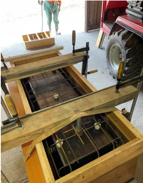
Abbildung 26 Hier sieht man die komplette Schalung und Armierung bereit fürs Betonieren. (Bowe, 2021)
