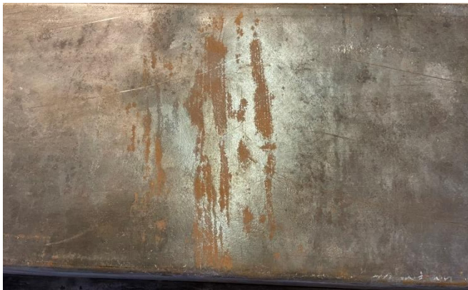
Abbildung 15 Hier sieht man Rostflecken auf der Innenschalung, die ich entfernen musste. (Bowie, 2021)
