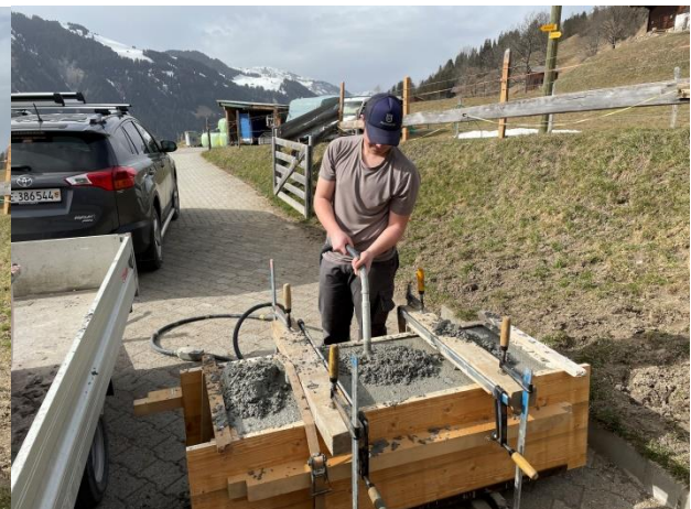
Abbildung 30 Auf diesem Bild sieht man mich, wie ich den Beton mit der Vibriernadel vibriere. (Bowie, 2021)
