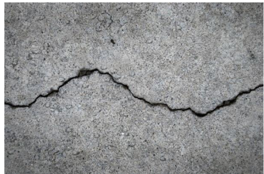
Abbildung 5 Hier sieht man einen Riss im Beton. Das kommt von dem Tau-Frost-Wechsel. (Hausjournal, 2021)
