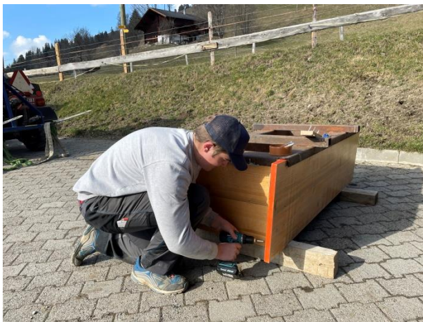
Abbildung 32 Auf diesem Bild sieht man mich, wie ich die Schrauben der Schalung löse. (Bowiee, 2021)
