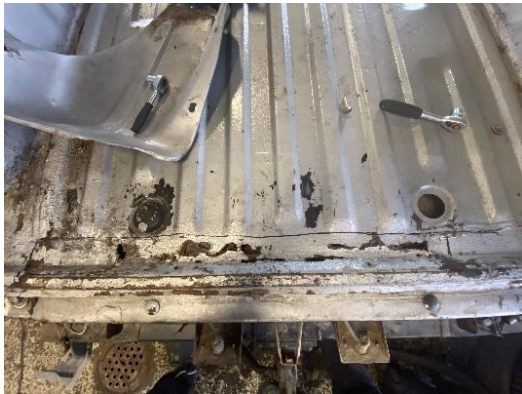
Abbildung 19 Rostlöcher, die unter einem Holzbrett hervorkamen
